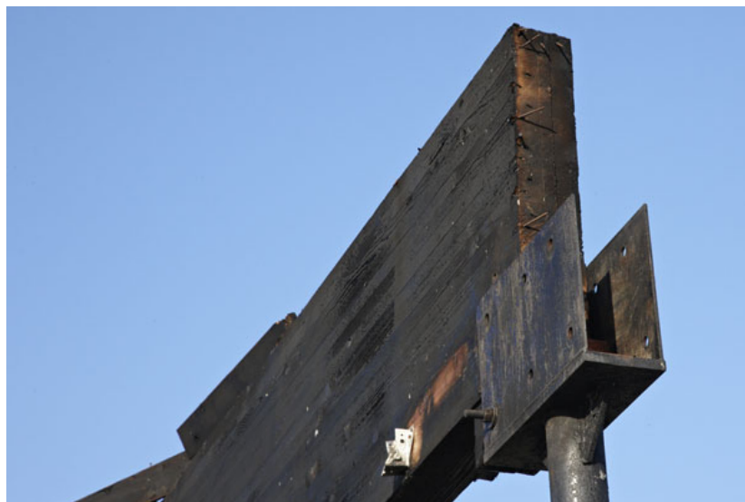
Rys. 5. Belka z drewna klejonego poddana działaniu pożaru – widok ogólny [1].
